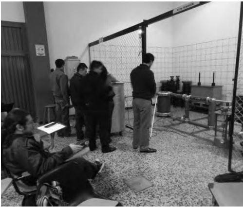
Figura 15. Módulo de trabajo de Laboratorio de Alta tensión
